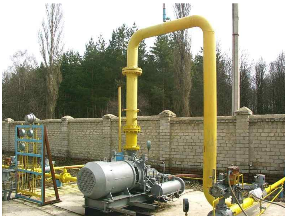
Рисунок 3.10 - Фото агрегата на стенде "ГРС-1 Сумы"
