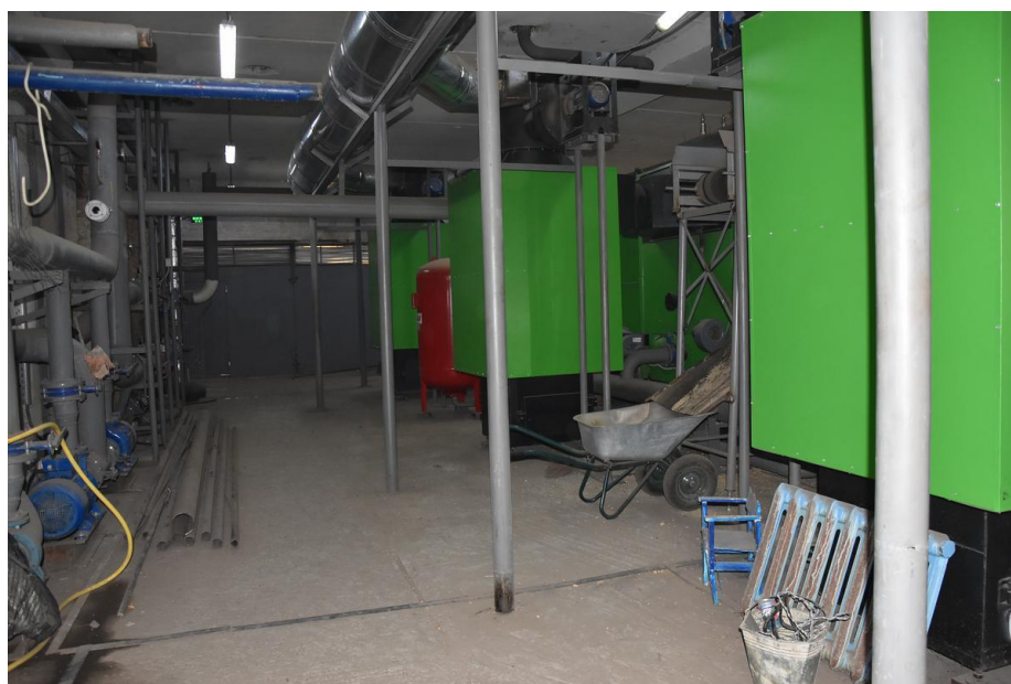
Рисунок 1.2 – Приміщення котельні КП «Обласна дитяча лікарня»
