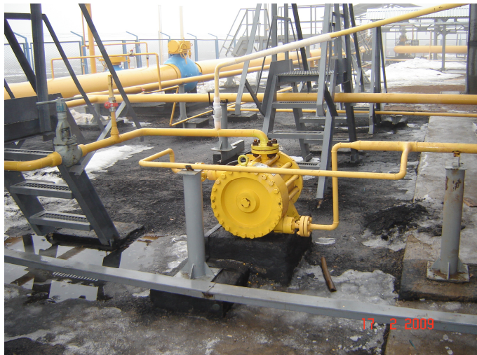
Рис. 3. Установка ДГУ-8-380-Т-У1 на "АГРС-5 Волгоград" Fig. 3. Installation ДГУ-8-380-Т-У1 at "AGDS-5 Volgograd"
