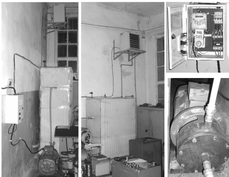
Рисунок 9 – Пілотна система опалення
