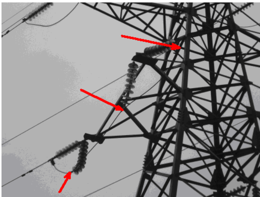
Рисунок 2.4 – Місце дефектного з'єднання на опорі ВЛ
