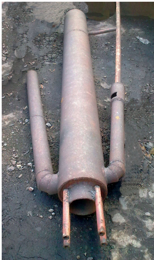
Рисунок 5.6 - Нижняя часть газожидкостного подъемника Старобешевской ТЭС
