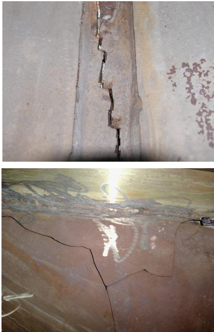
Рисунок 1.5 – Втомні тріщини на стінці корпусу вихлопного тракту газоперекачувального агрегату
