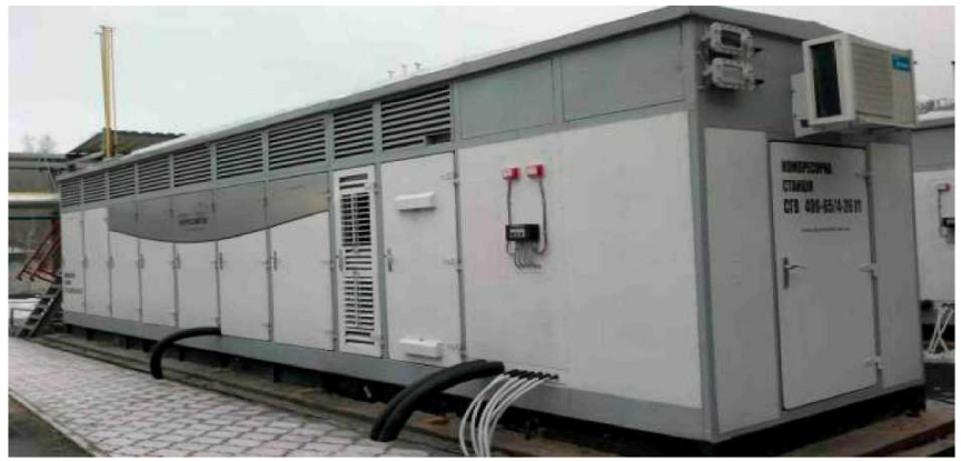
Рисунок 3.25 – Дотискна компресорна станція
