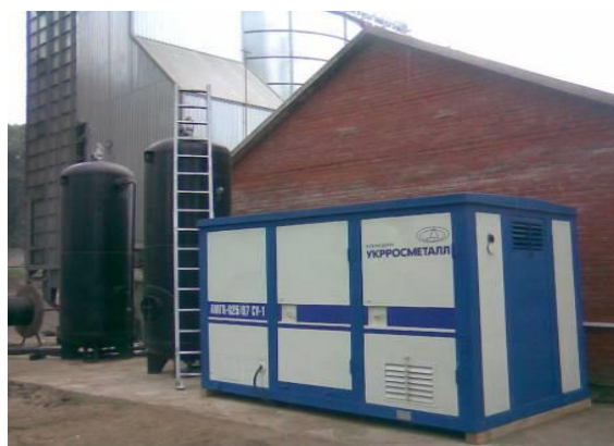
Рисунок 5.46 – Азотна станція на хлібокомбінаті (м. Суми)
