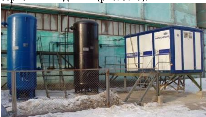
Рисунок 5.45 – Азотна станція на елеваторі (м. Карлівка, Полтавська область)
