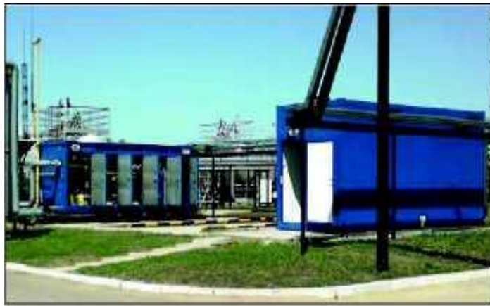
Рисунок 3.30 – Компресорний контейнер і контейнер КІП і А
