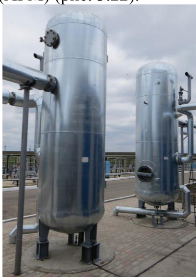
Рисунок 3.20 – Ресивери повітря і азоту станції ААВН-40/25У1
