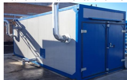
Рисунок 3.17 – Модуль підготовки стисненого повітря станції ААВН-40/25 У1
