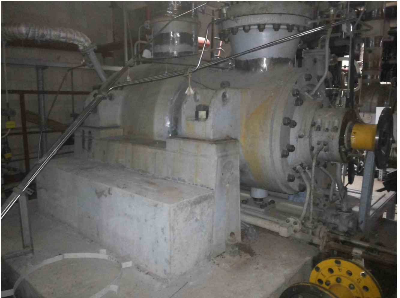
Рисунок 3.15 – Двоборпусний відцентровий живильний насос на місці постійної експлуатації
