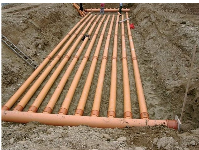
Рисунок 5.1 – Труби для збирання підземного тепла/прохолоди (Закопана, 2015)
