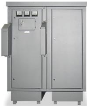
Рисунок 5.28 – Конденсаторна установка типу УКРЛ56-6,3 (вигляд зовні)
