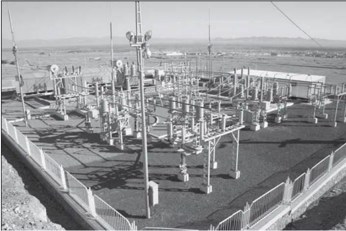
Рисунок 4.14 – Відкрита трансформаторна підстанція
