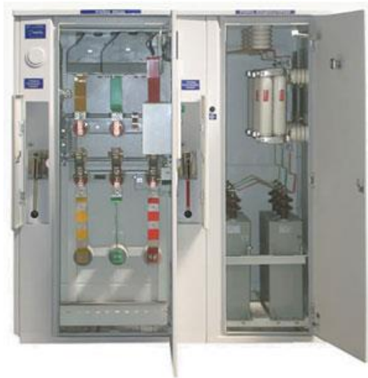
Рисунок 5.29 – Конденсаторна установка типу УКЛ56М-6,3(10,5)(вид зовні)
