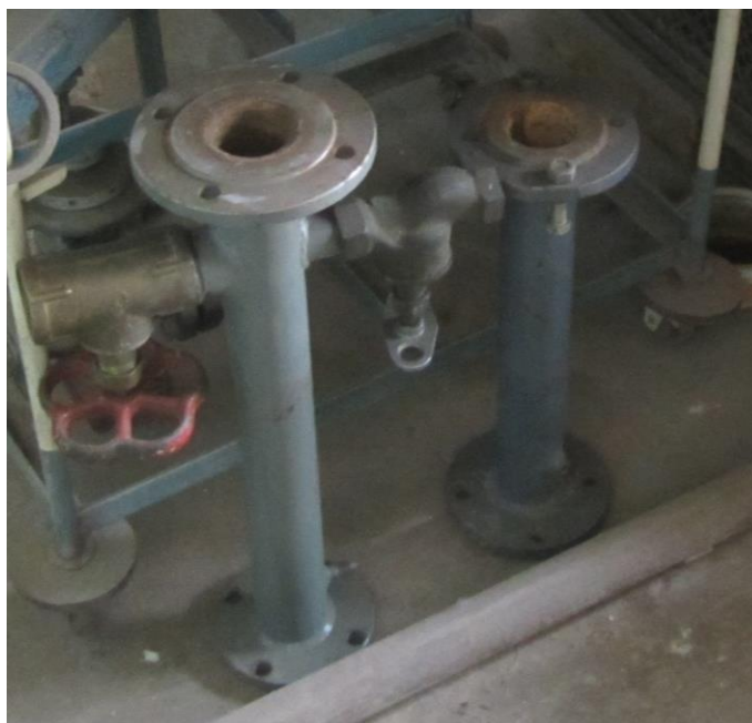
Рисунок 2.23 – Крани ДУ25 для з'єднання трубопроводу з атмосферою
