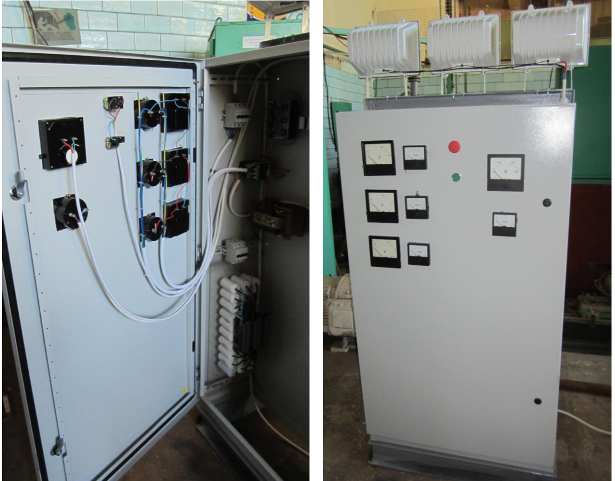
Рисунок 2.20 – Шафа з приладами та пристроями системи силового підключення, контролю та регулювання електроенергії, що виробляється
