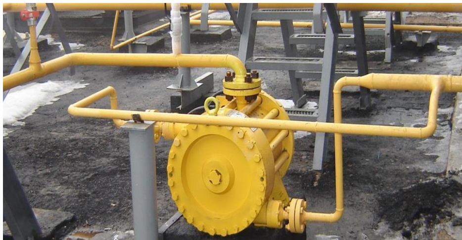
Рисунок 1.8 – Конструкція турбогенератора на базі асинхронного електрогенератора і вихрової розширювальної машини на АГРС-5 м. Волгоград.
