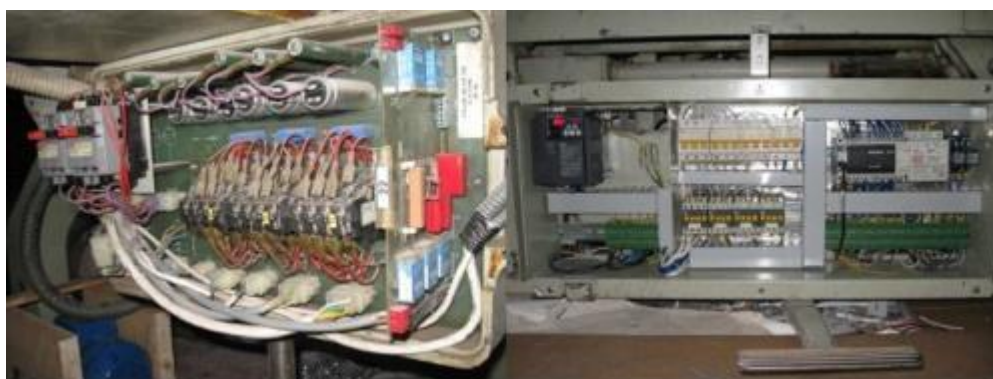
Рисунок 1.2 - Перекомутація електричної шафи печі випікання
