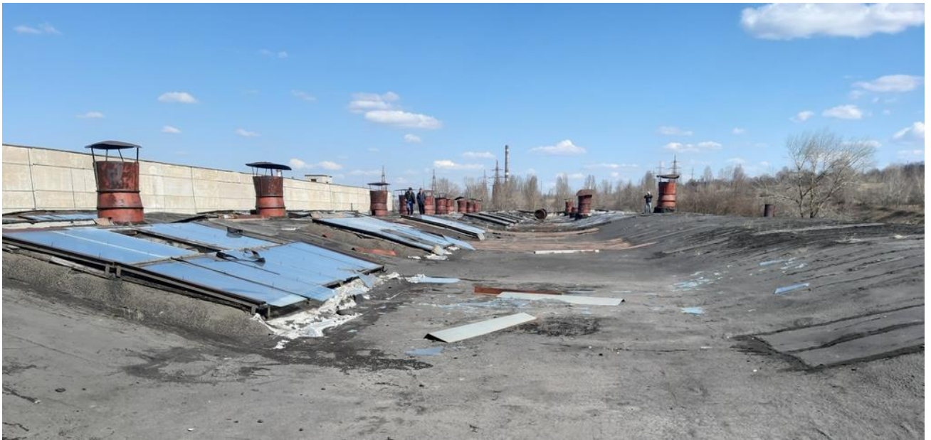
Рисунок 3.2. Покрівля для розміщення промислової СЕС[26]
