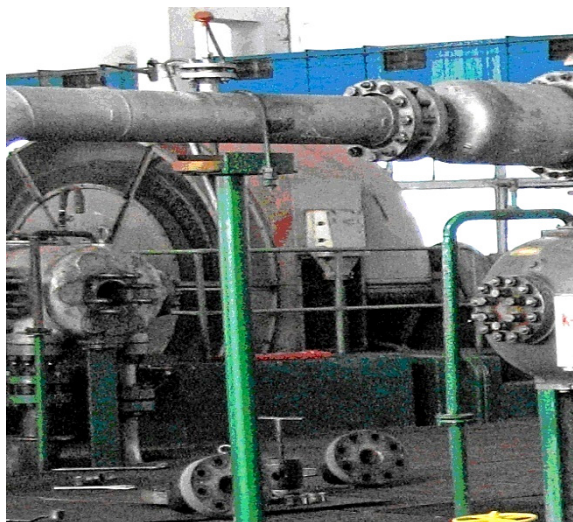
Рисунок 7.16 – Компресор двоокису вуглецю 4ДВК-210-10 поз. К-102 і електродвигун приводу компресора
