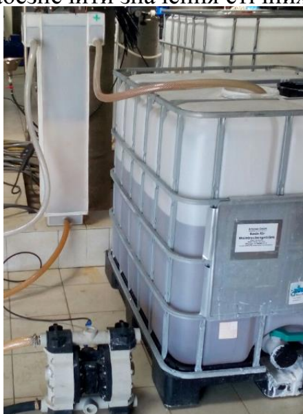
Рисунок 3.8 – Зовнішній вигляд обладнання для рН-корекції стічних вод ТОВ «БІТ-Сплав» (промислові дослідження рН-корекції)
