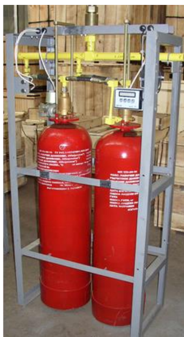
Рисунок 1.2 - Модулі газового пожежогасіння
