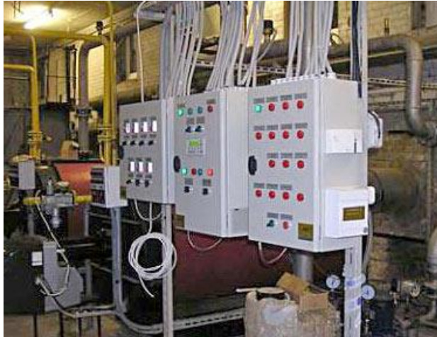
Рис.3.6. Шафи керування з встановленими ПЛК [21]
