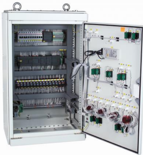
Рисунок 3.14 – Загальний вигляд шафи збору та передачі даних
