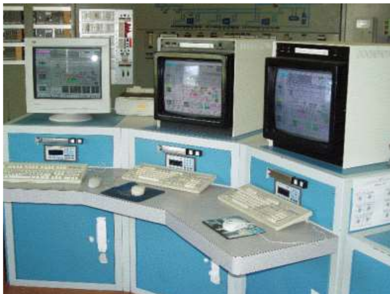
Рисунок 3.5 - Станція контролю і управління MOIS
