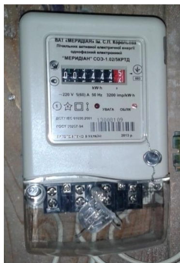
Рисунок 2.3 – Лічильник електричної енергії [10]
