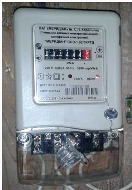
Рисунок 1.4 – Лічильник електричної енергії [5]
