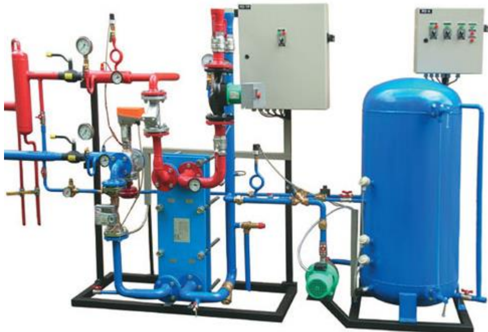
Рисунок 4.1 – Зовнішній вигляд ІТП
