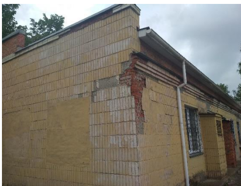
Рисунок 1.6 – Обсіпання фасадної плитки зі стін
