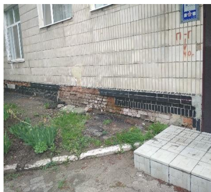
Рисунок 1.7 – Обсіпання фасадної плитки з фундаменту
