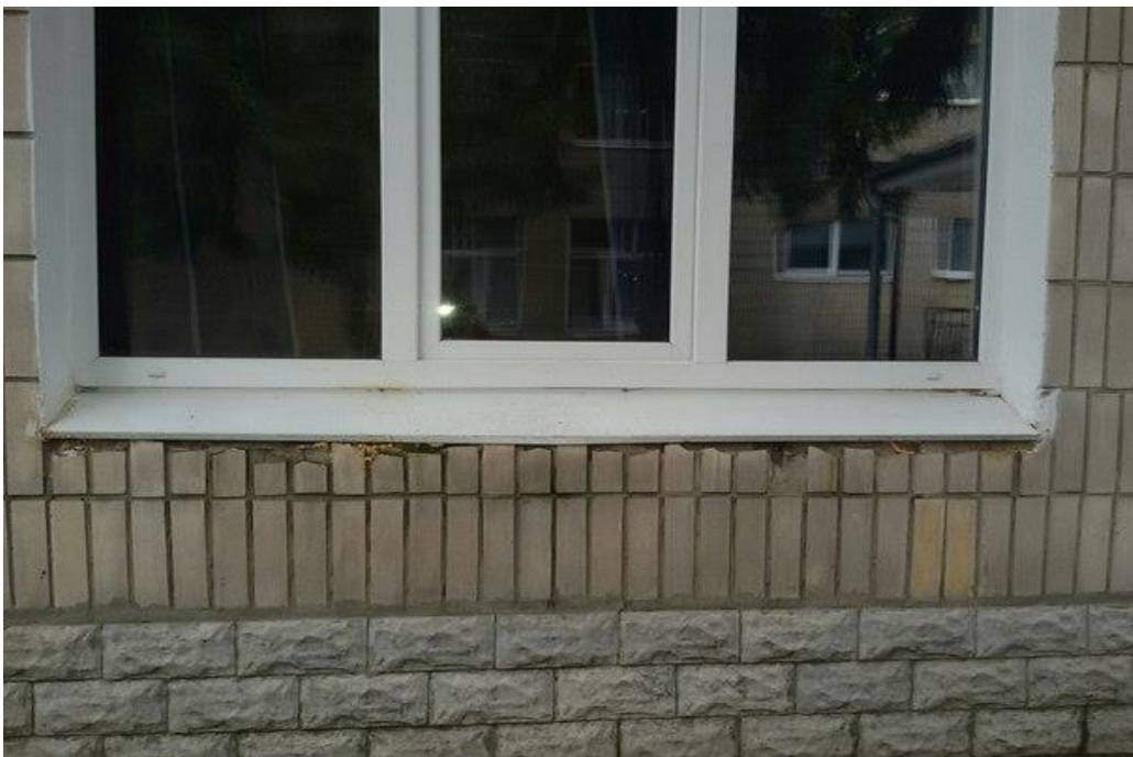
Рисунок 1.2 – Неякісно встановлені віконні відливи
