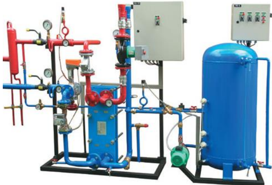
Рисунок 2.1 – Зовнішній вигляд ІТП
