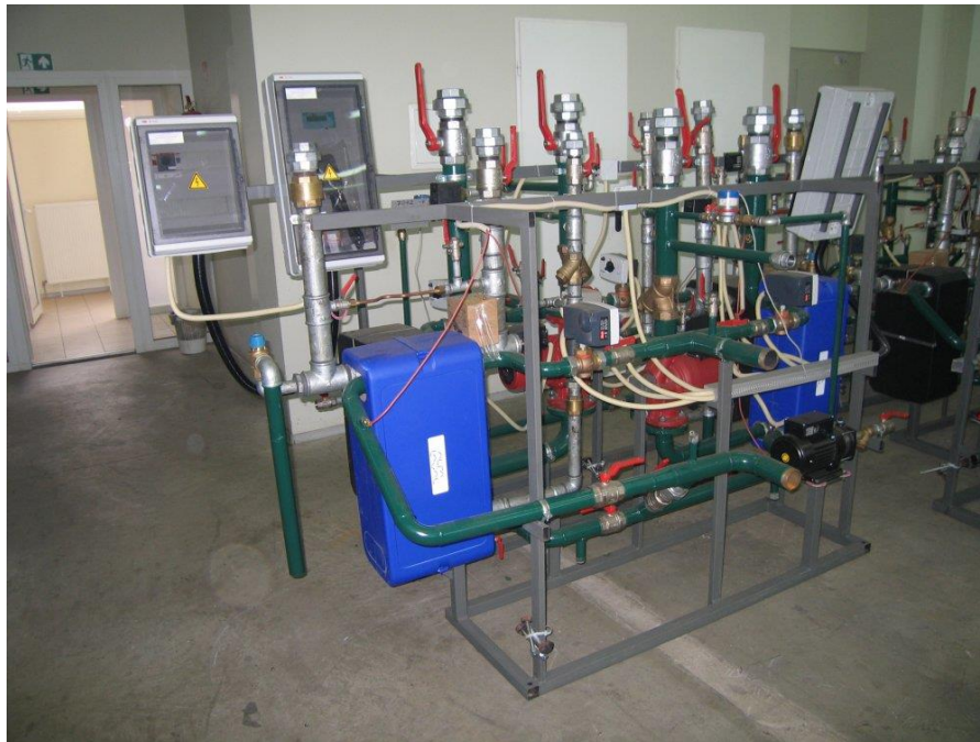
Рисунок 2.5.2 – Індивідуальний тепловий пункт ІТП-250 кВт
