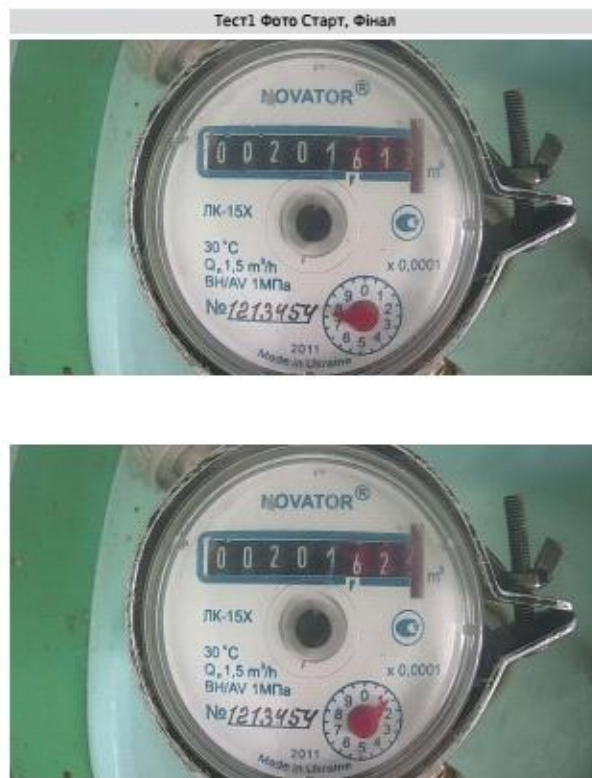
Рисунок 3.12 – Фото лічильника води
