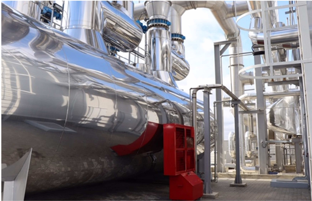
Рисунок 1.1 – Автоматизована станція з рекуперації етилацетату.
