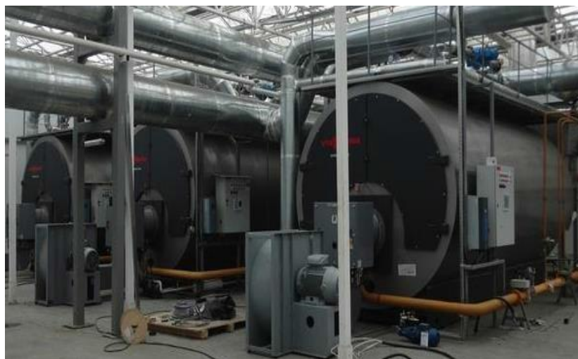
Рисунок 1.5 – Котел системи опалення
