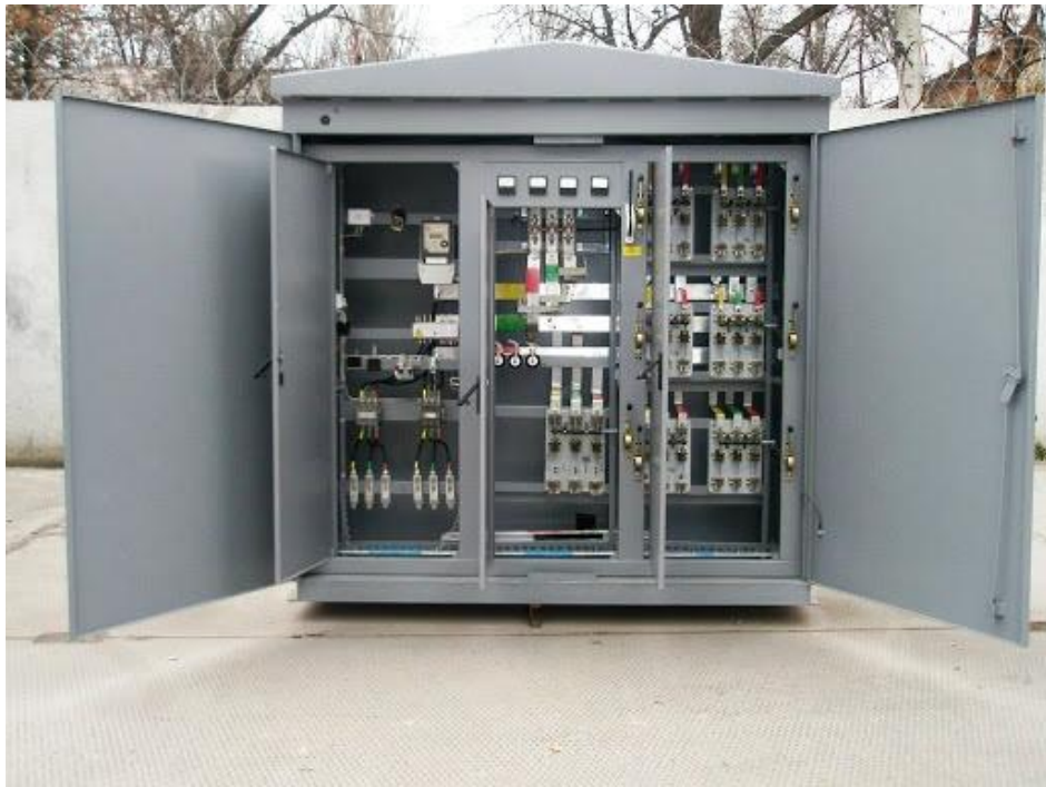
Рисунок 3 – Вигляд трансформаторної підстанції
