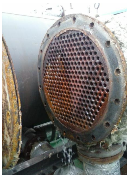
Рисунок 9 – Кожухотрубний теплообмінник з корозією трубок
