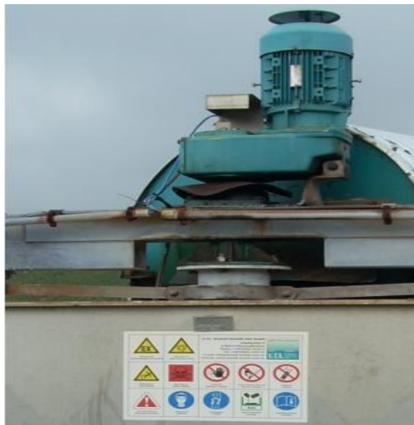
Рисунок 4.1 – Попереджувальні знаки безпеки на системі подачі АП
