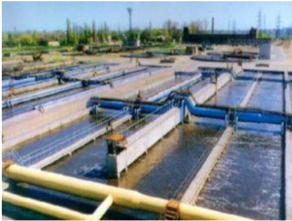
Рисунок 2.4 – Аеротенк у складі міських очисних споруд
