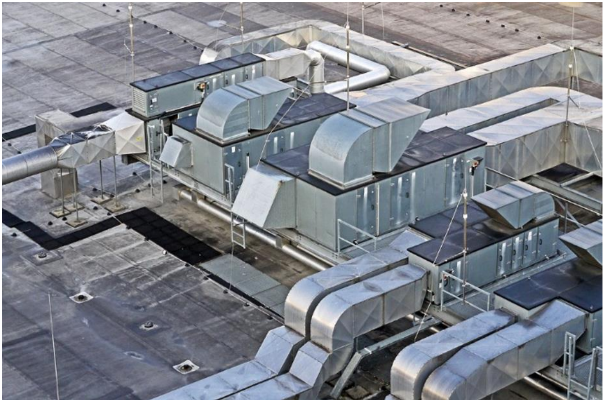
Рисунок 1.1 – Системи оброблення повітря, розташовані на покрівлі будинку
