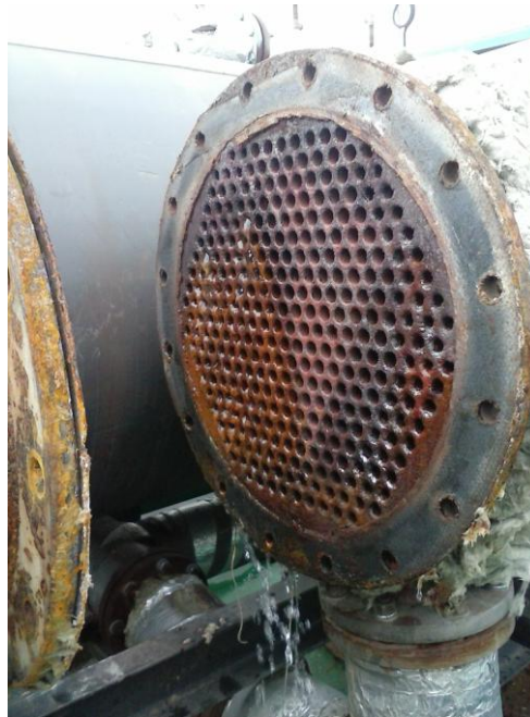
Рисунок 4.4 – Кожухотрубний теплообмінник з корозією трубок
