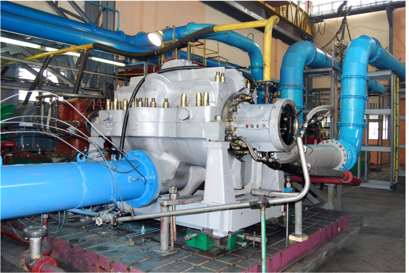
Рисунок 1.4 – Загальний вид компресора Д203ГЦ1-710/2,4-10М2 ДКС СОГ-4
