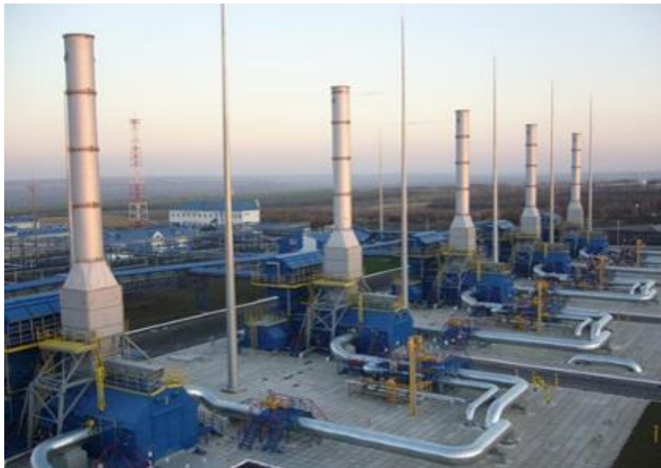
Рисунок 1.1 – Компресорна станція (загальний вигляд)
