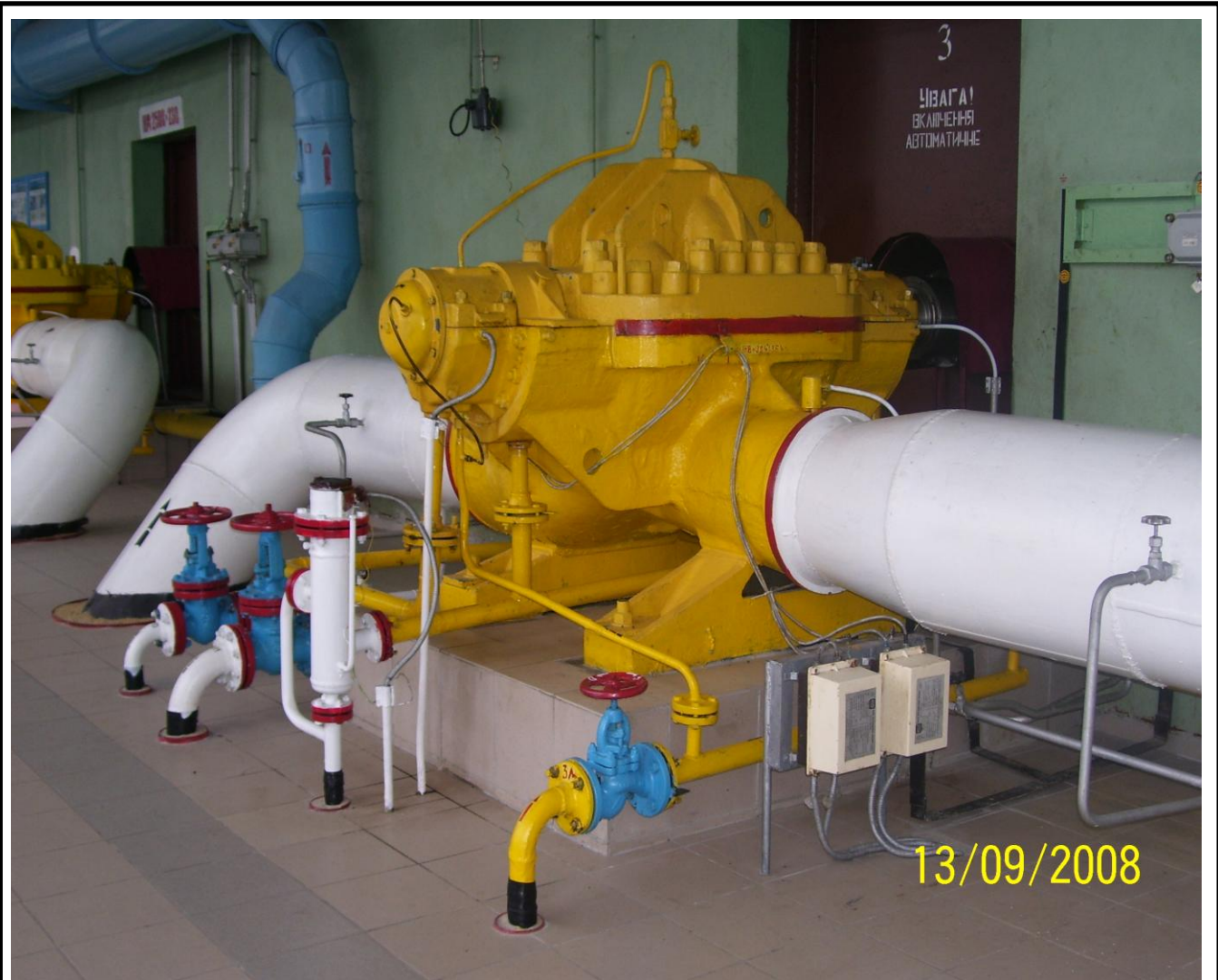
Рисунок 1.2. Магістральний насос МН2500-230
