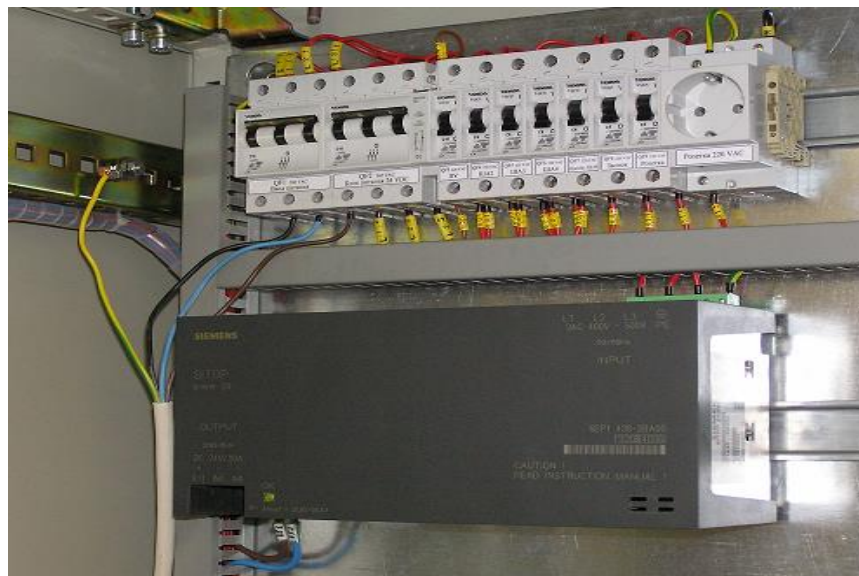
Рисунок 1.1 - Автоматичні вимикачі QF1- QF9, розетка 220VAC, стабілізоване джерело живлення SITOP POWER 20.
