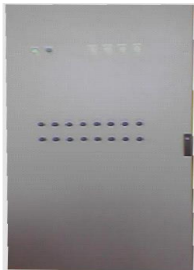
Рисунок 2.6 - Шафа автоматики ША1
