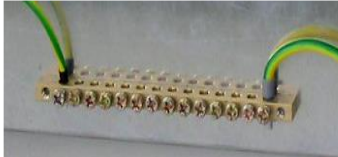
Рисунок 2.13 - Мідна шина заземлення
