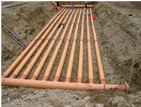
Рисунок 5.4 – Труби для збирання підземного тепла / прохолоди (Закопана, 2015)
