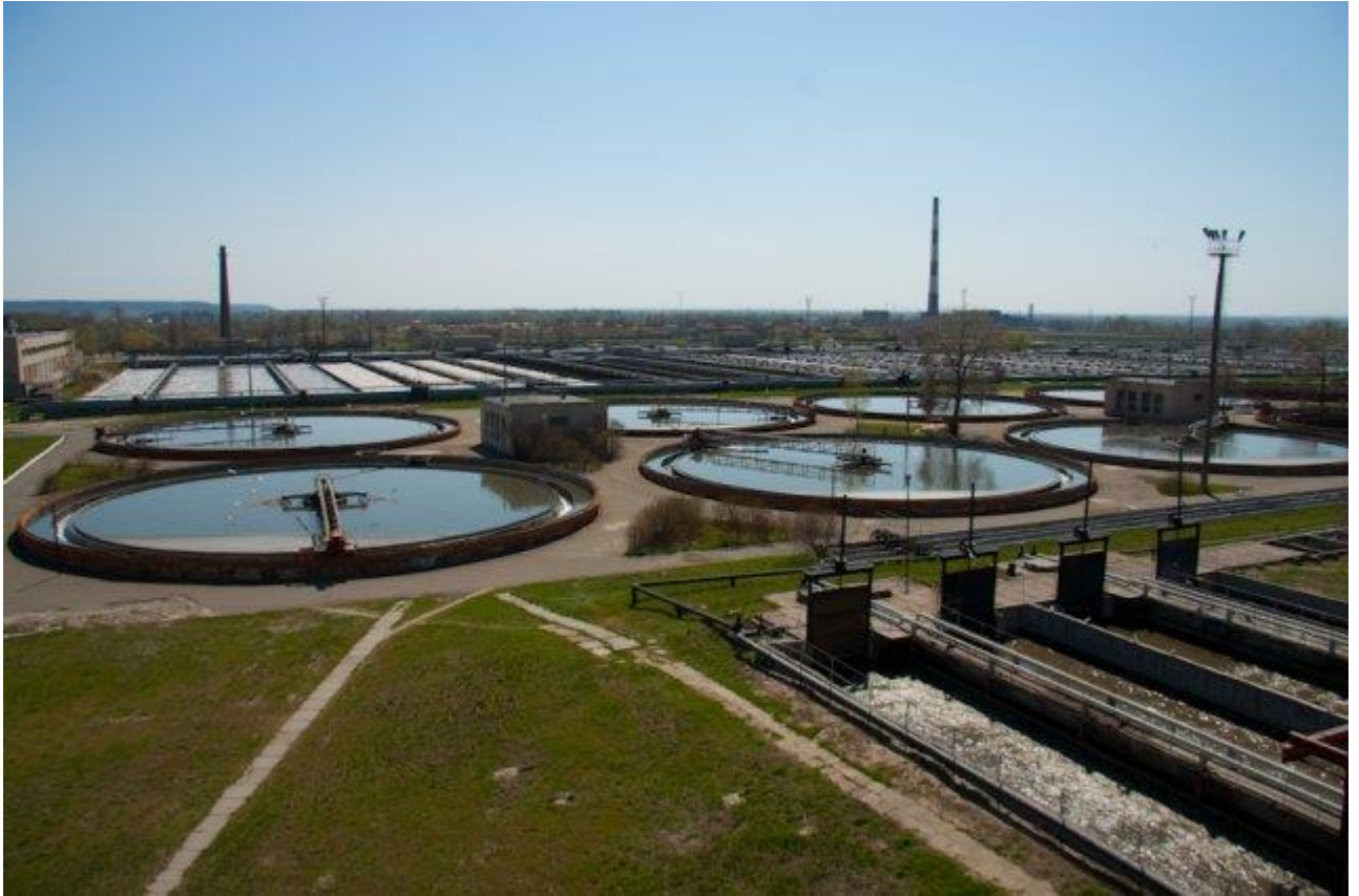
Рисунок 2.4 – Аеротенк у складі міських очисних споруд (фото: https://vodokanal.kiev.ua/ )
