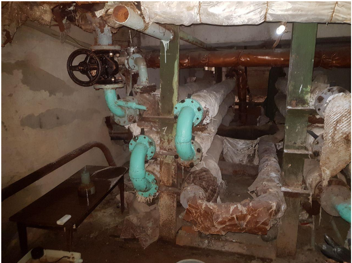
Рис.4.1 – підвальне приміщення з бойлерами.
