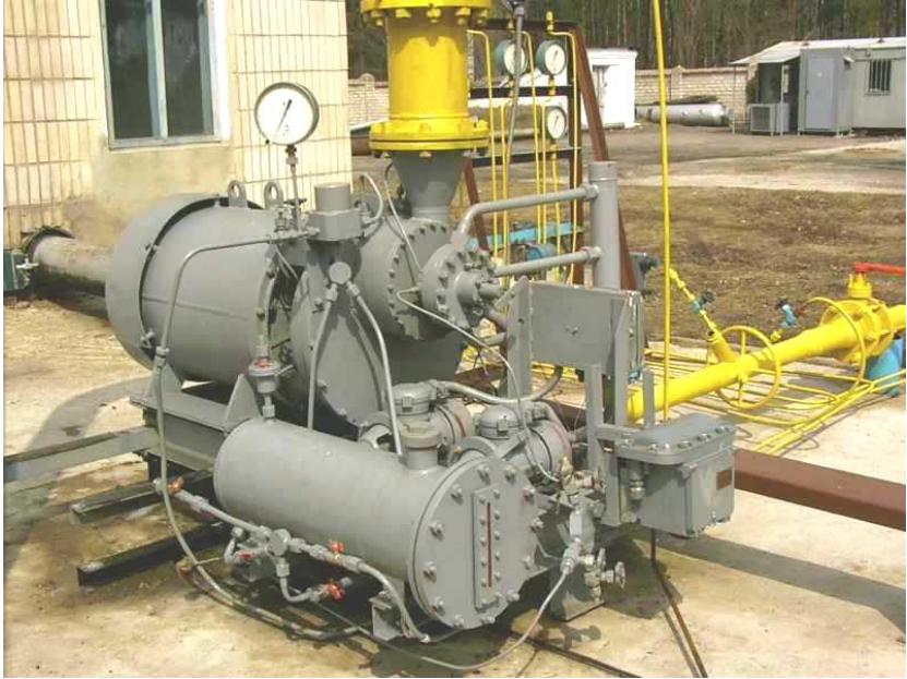
Рисунок 13.9 –ТДА-СРТ-100 на газорозподільній станції ГРС-1 Суми
