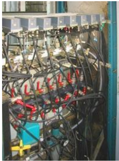
Рисунок 34 – Шафа з перетворювачами електричних та пневматичних сигналів ЕПП та ПЕП
