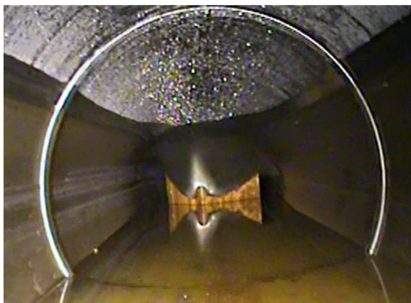
Рисунок 1.5 – Кадр відеоінспекції труби водовідведення
