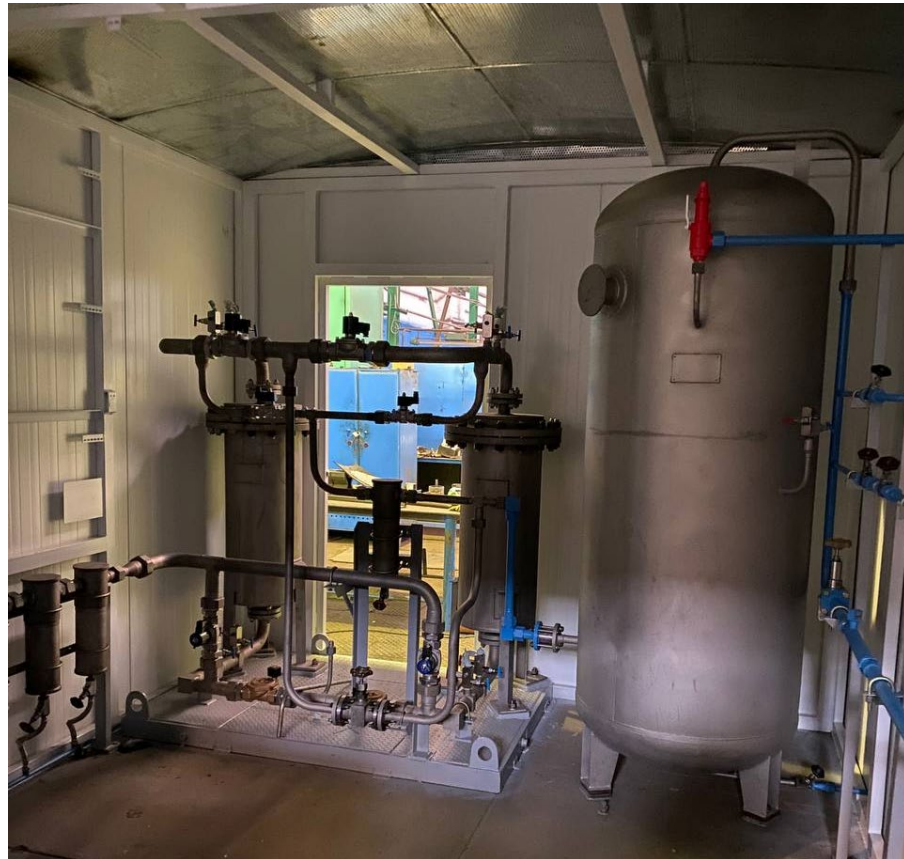
Рисунок 1.3 – Контейнерне виконання установки з генерації медичного кисню
