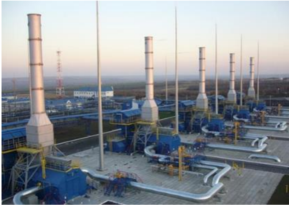
Рисунок 1.1 – Компресорна станція (загальний вигляд)
