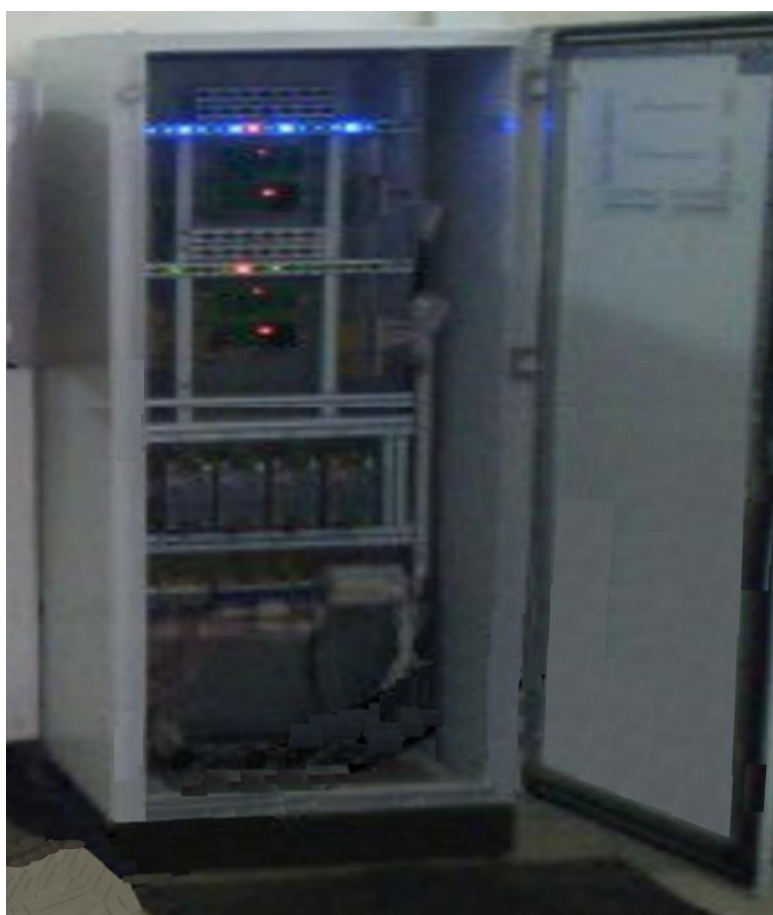
Рисунок 4.4– Шафа з обладнанням Siemens SIMATIC S7-300
