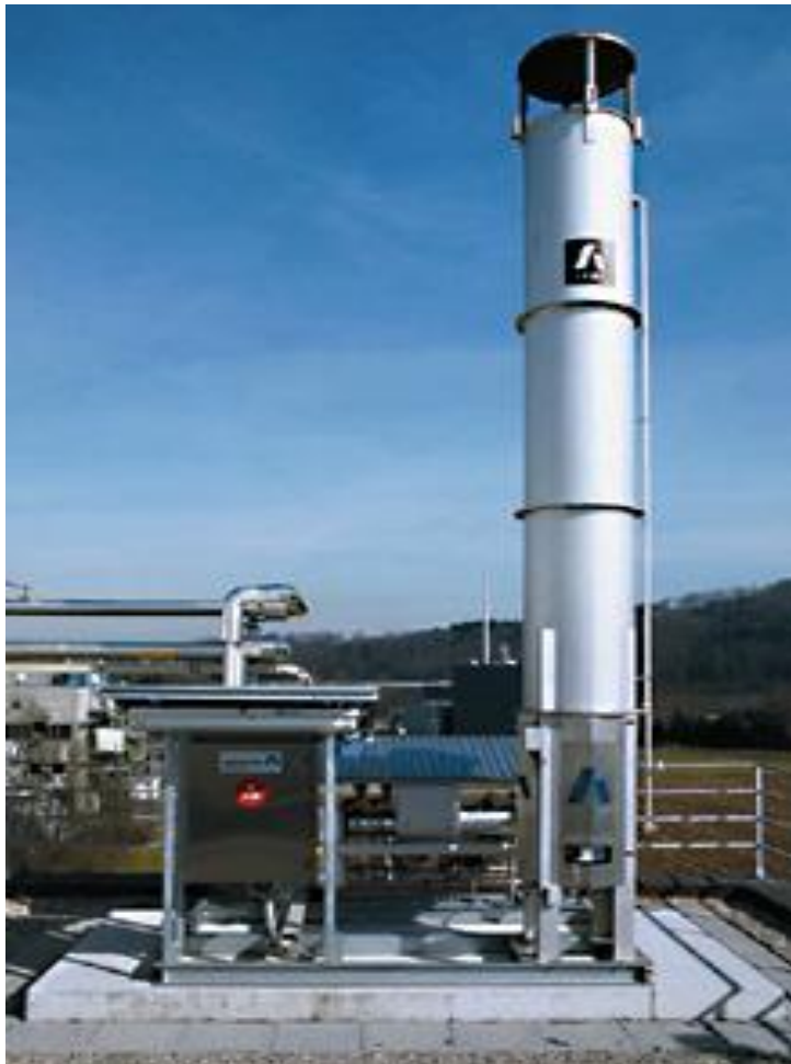
Рисунок 3.9 – Факельная установка для зпалювання лишку біогазу
